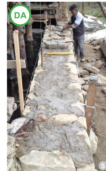
AȘA DA: Folosirea pietrei pentru zidurile și fundațiile construcțiilor noi este optimă în zonele cu umiditate mare.
