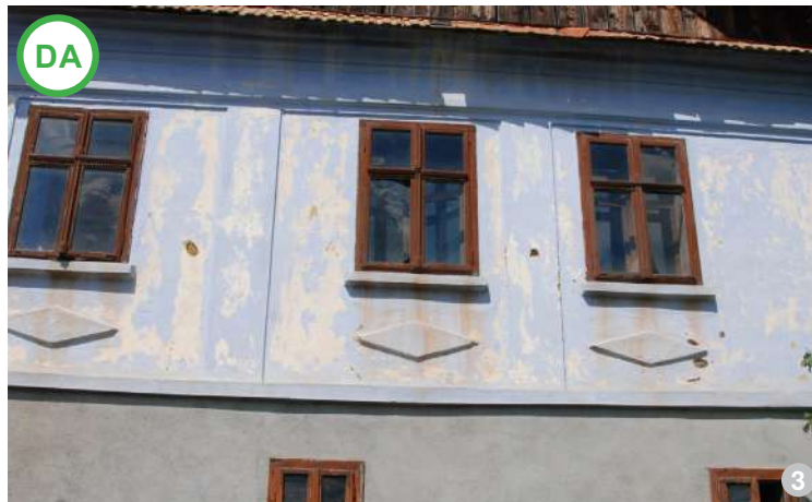
AȘA DA: Zidurile din piatră tencuite cu mortare pe bază de var reprezintă două tipuri de materiale compatibile.
