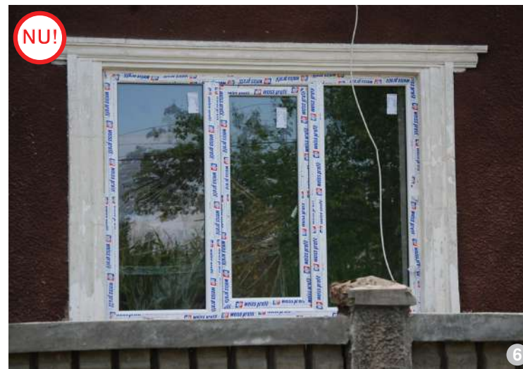
AȘA NU: Schimbarea tâmplăriei tradiționale cu cea de PVC nu este adecvată.
