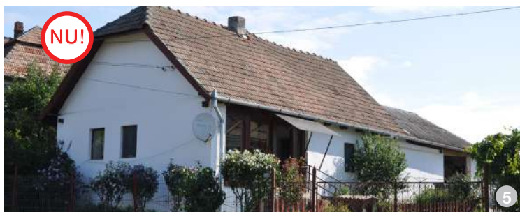
AȘA NU: Clădire tradițională după intervenție: s-au îndepărtat elementele caracteristice ale fațadei, precum sunt decorațiile, tâmplăriile, țiglele, cornișa, în locul cărora s-a montat o tâmplărie din PVC, material necaracteristic zonei, s-au distrus decorațiile istorice, montându-se, probabil, în schimb o termoizolație din polistiren.
