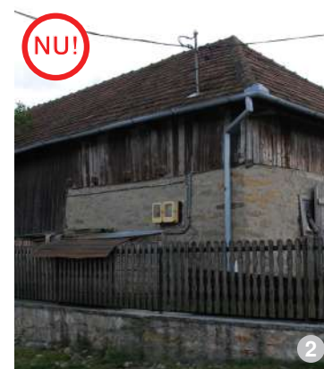
ASA NU: Se interzice montarea contoarelor electrice pe fațada de la stradă, acest lucru riscând să deterioreze decorațiile sau alte inscripții încă nedecapate și urâtind în același timp fațada. Se recomandă montarea lor în interiorul incintei, legislația prevăzând că acestea trebuie montate în locuri ușor accesibile și nu neapărat pe fațada de la stradă, așa cum se întâmplă adesea.
